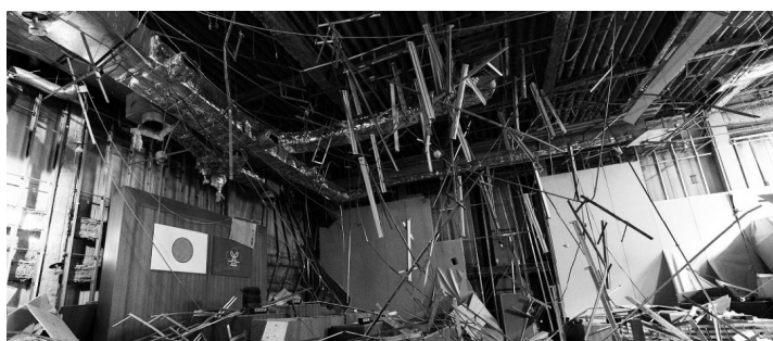
熊本地震の被災状況
